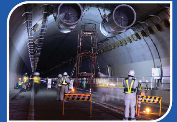
Hệ thống chiếu sáng, lọc bụi và quạt thông gió hầm
